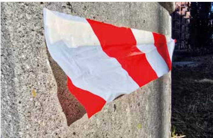
Abb. 3: Kunststoffabspermband an einer Fassade. Die Unterkante muss lose hängen. Foto: Stadt Zürich
