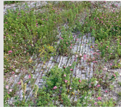
Unverfugte Steine neben Chausseurierung (Wankdorf City)
